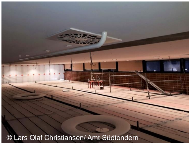
Blick auf die raumluftechnische Anlage
